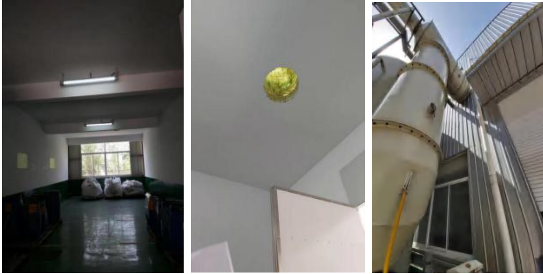
图 4-20 危废仓库内照明设施、废气收集装置现状图
