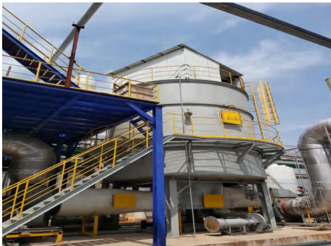
图 4-5 二、三、四车间废气处理装置（RTO 焚烧炉装置）现场图
