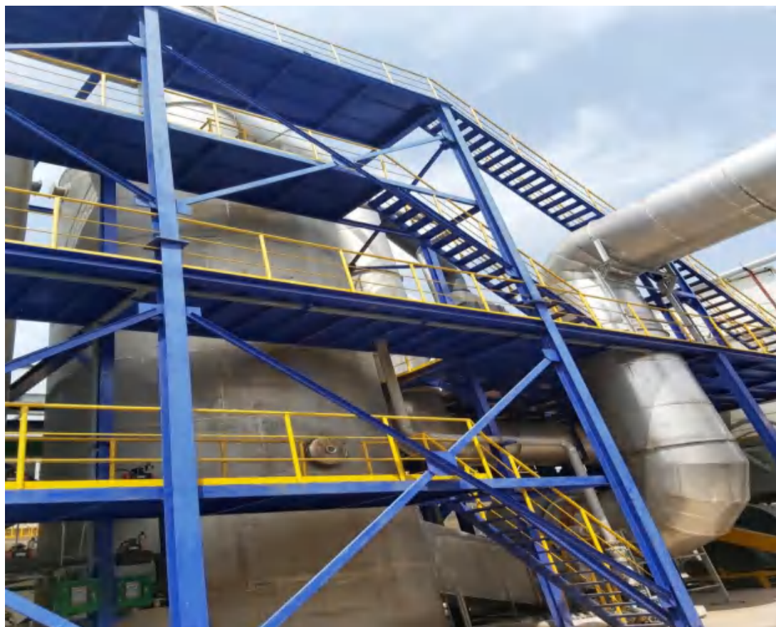
图 4-4 二、三、四车间废气处理装置（二级水喷淋装置）现场图
