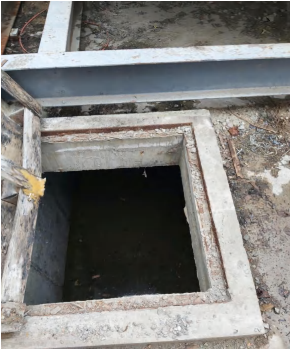
图 4-29 项目初期雨水池照片（350m 3 ）
