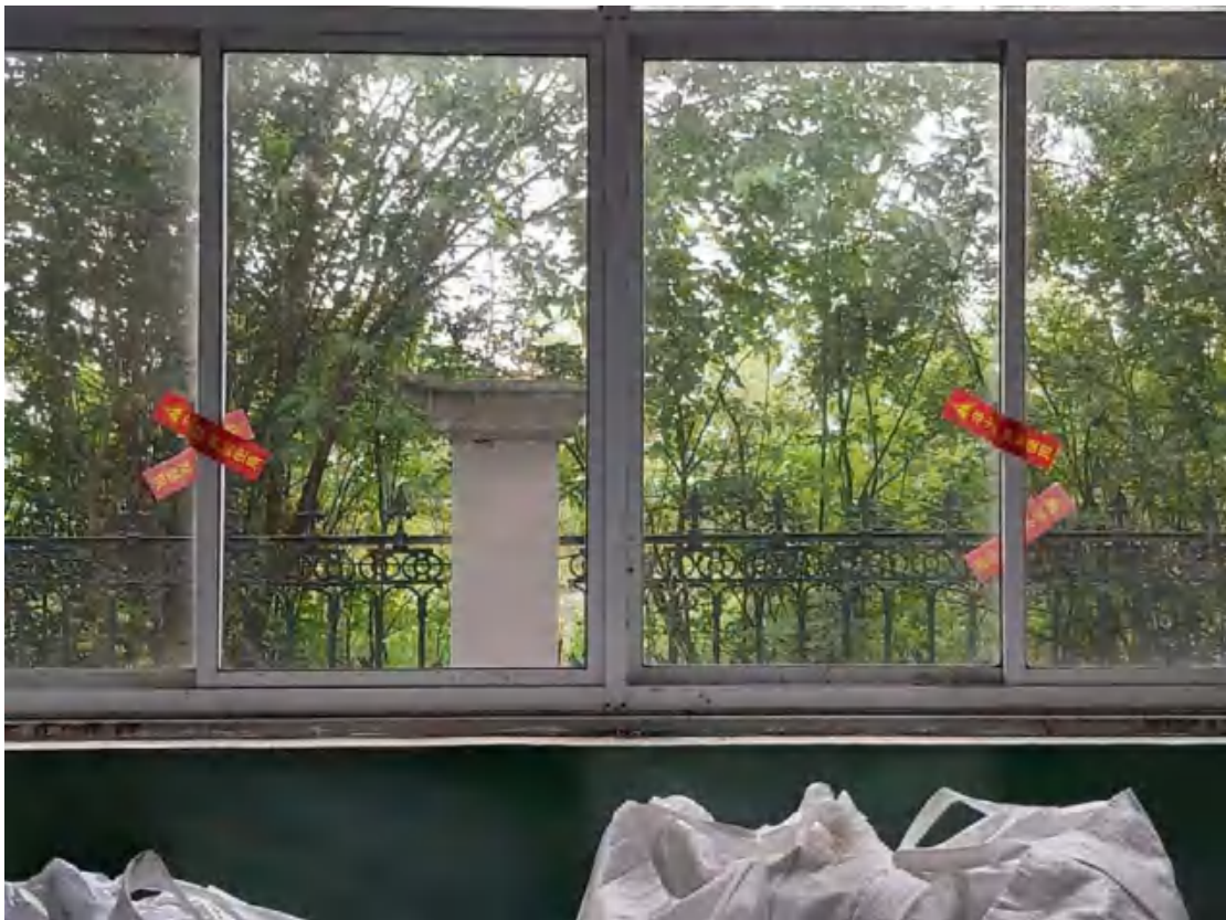
图 4-23 项目危废仓库窗户封条现状图
