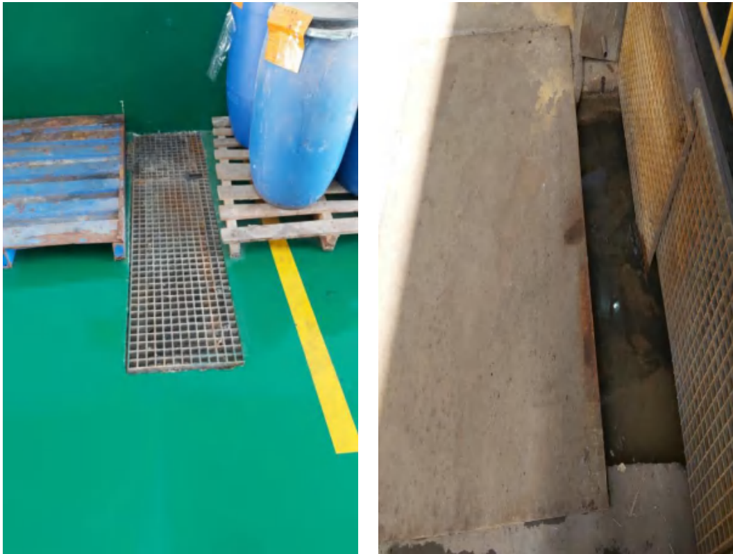
图 4-19 危废仓库导流槽、收集井现状图
