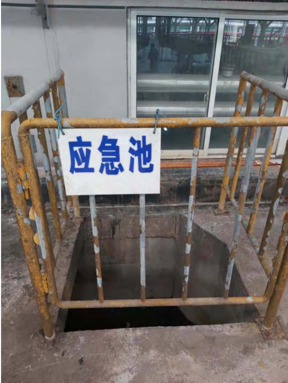
图 4-30 项目事故应急池照片（500m 3 ）
