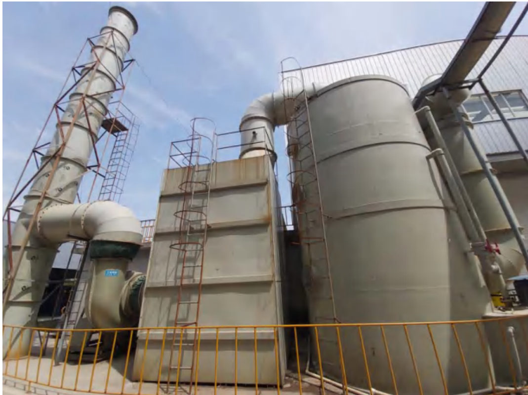
图 4-7 危废仓库废气处理装置（碱喷淋+活性炭吸附装置）现场图
