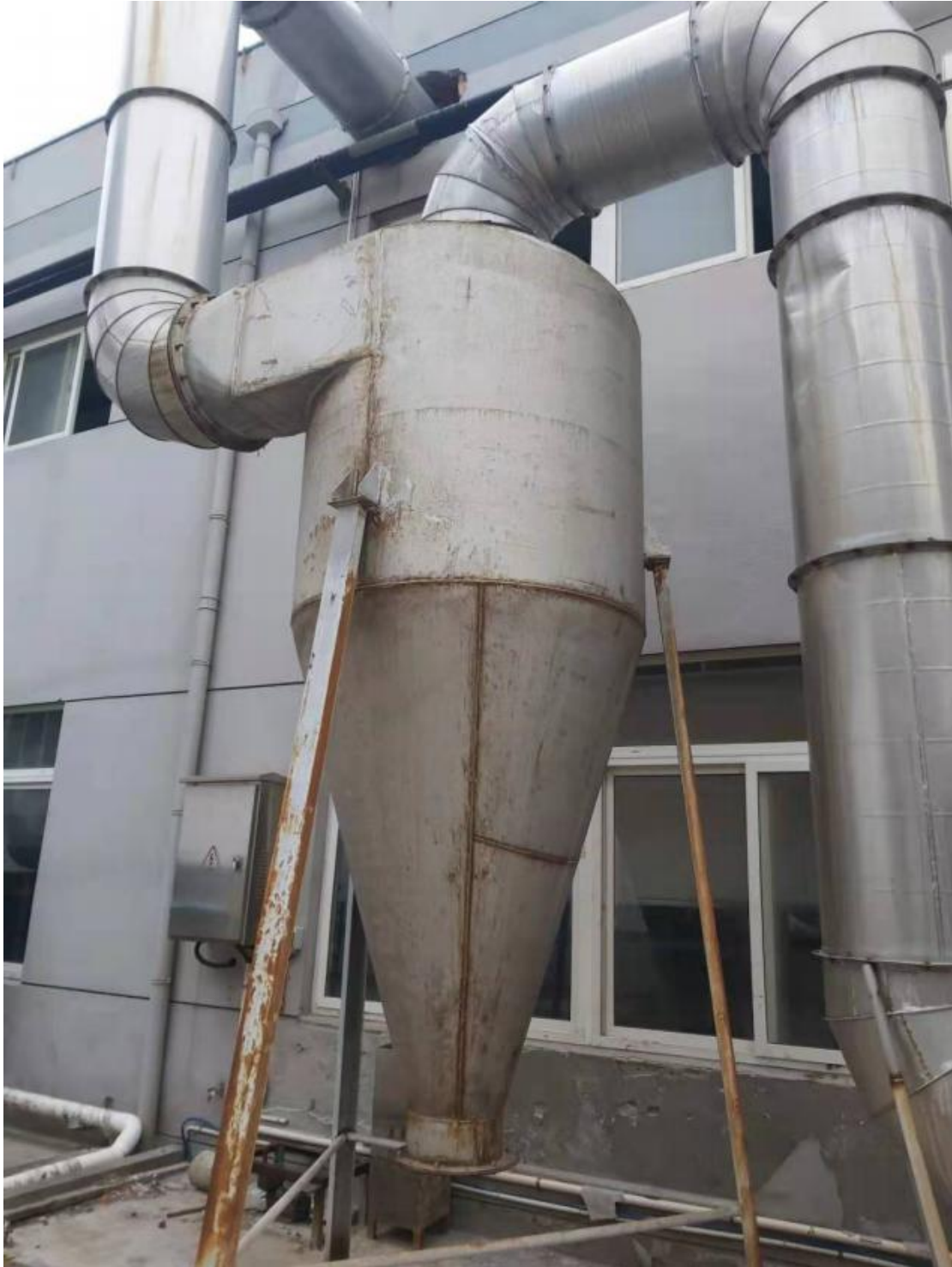
图 4-8 配料中心废气处理装置（布袋除尘装置）现场图
