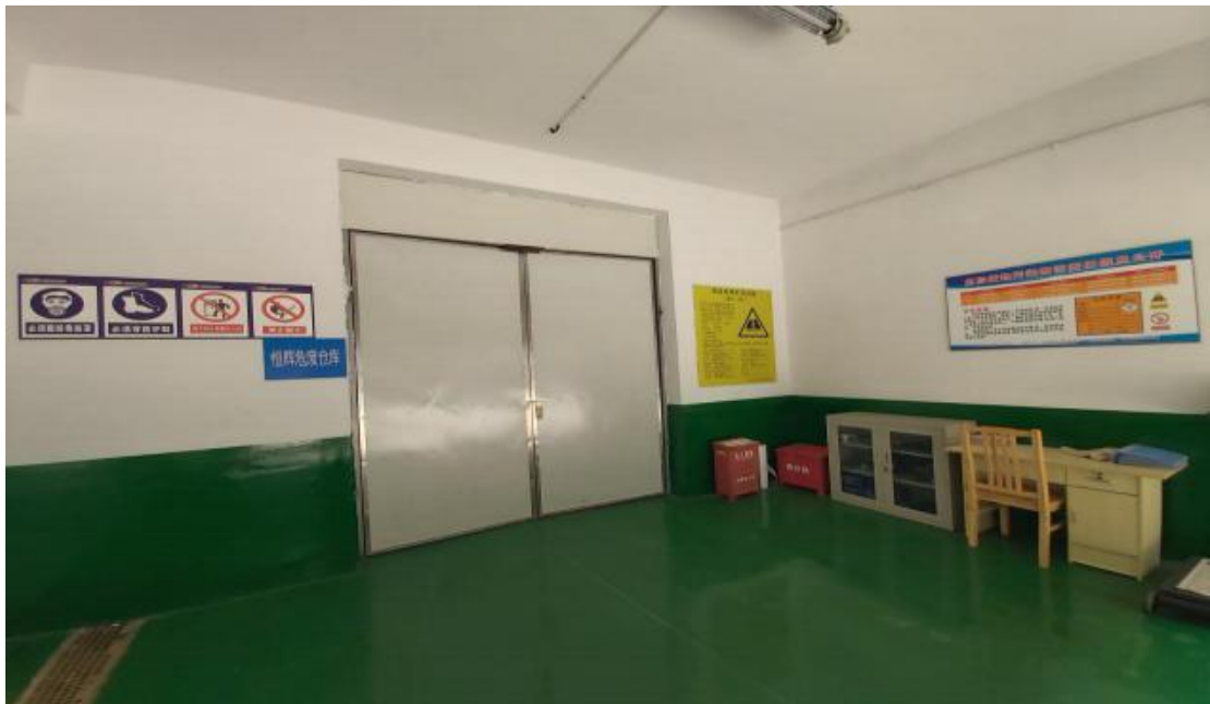
图 4-17 项目危废仓库外部图、大门上锁图
