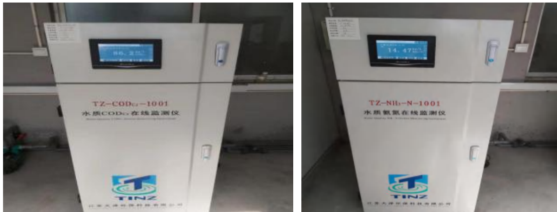
图 4-33 废水在线监测设备现状图
