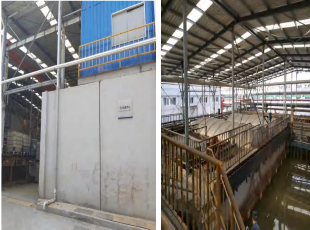
图 4-9 1300 吨/日综合废水处理设施现场图片
