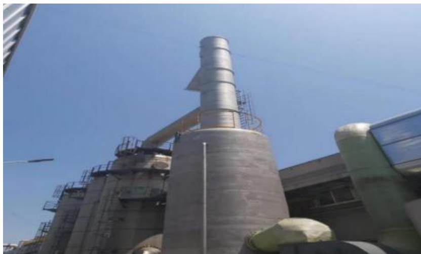
图 4-34 项目一车间 DA004#排气筒现状图
