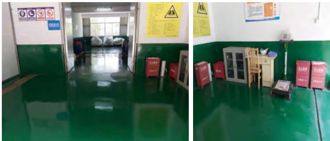
图 4-15 项目平面固定式贮存设施警示标志牌及消防设施现状图
