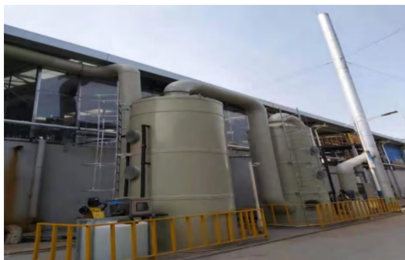
图 4-36 项目配料中心、污水站 DA001#排气筒现状图
