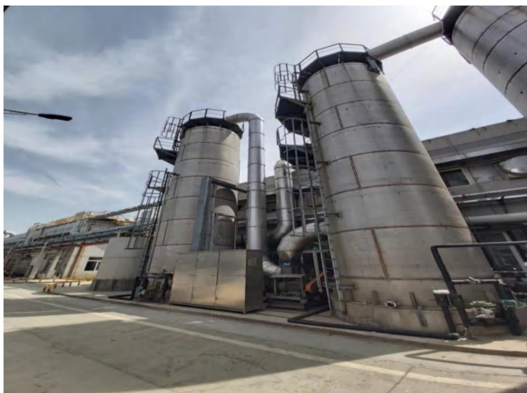
图 4-3 PU 车间废气处理装置（二级水喷淋装置）现场图
